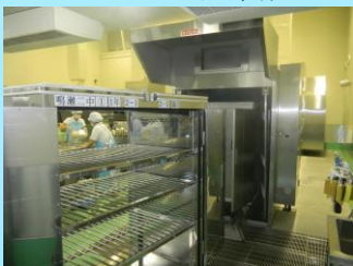
コンテナ洗浄機
